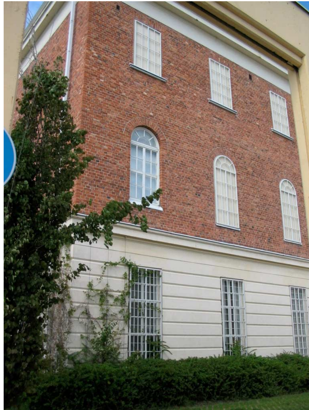
Osa alkuperäisen rakennuksen julkisivua, jossa näkyy muutostöiden yhteydessä (1989-1990) umpeen muurattuja ikkuna-aukkoja, jotka on jätetty ikkunamuistumina julkisivuun
